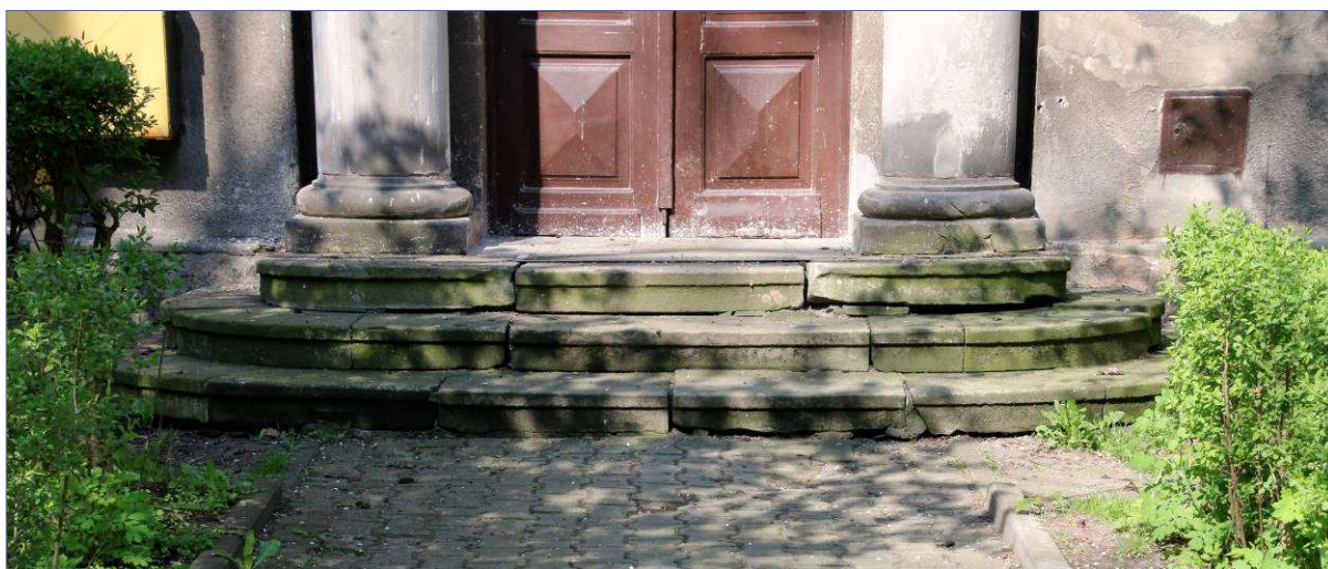
schody wejściowe na elewacji frontowej - brak spoinowania pomiędzy kamiennymi ciosami zdegradowane łączenia powodujące uszkodzenia i osłabienie konstrukcji, widoczne znaczne spękania dolnej części baz kolumn, zwłaszcza tej po prawej stronie; korozja biologiczna
