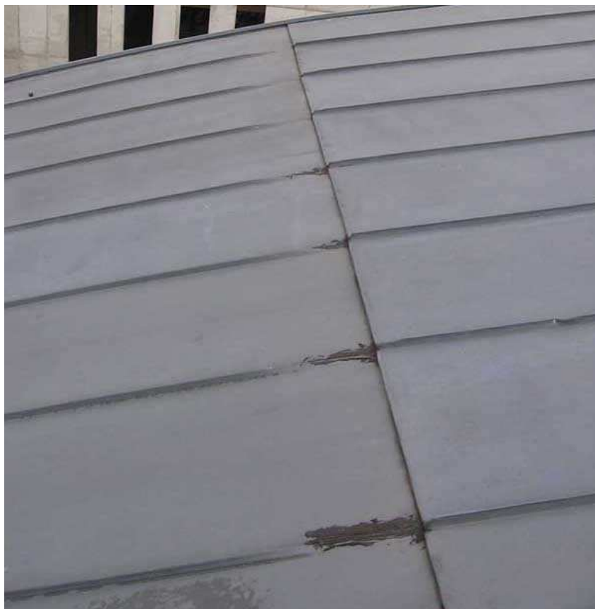
foto. widok pokrycia, połąć łukowa, uszczelnienia żywicą. Źle wykonane łączenia arkuszy, brak zakładki wlotowanej
