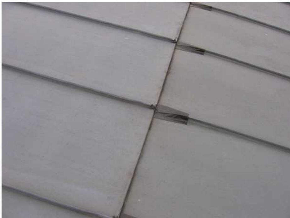
foto. widok istniejące łączenie arkuszy blachy w części łukowej dachu, widoczne reperowane żywicą i taśmami
