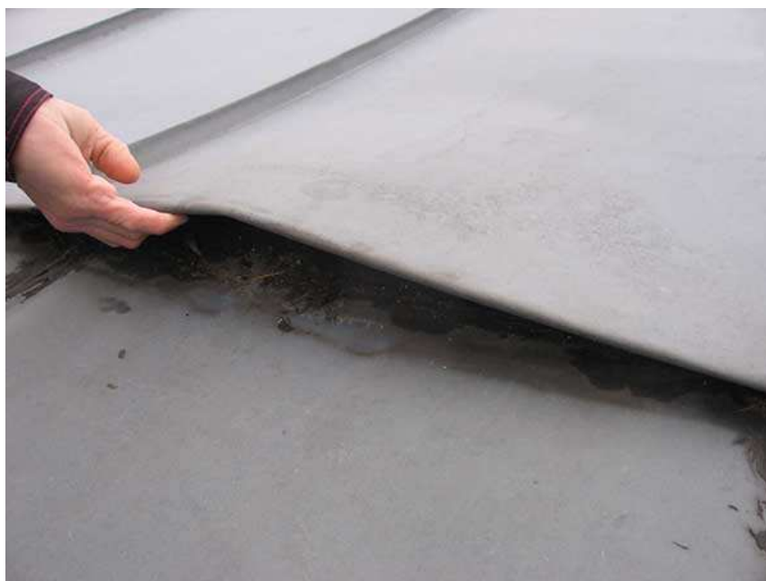
foto. widok pokrycia, uszczelnienia żywicą. Źle wykonane łączenia arkuszy, brak zakładki wlotowanej, i odpowiedniej długości zakładki arkusza blachy. Dobrze wykonane łączenie uniemożliwia podniesienie arkusza.
