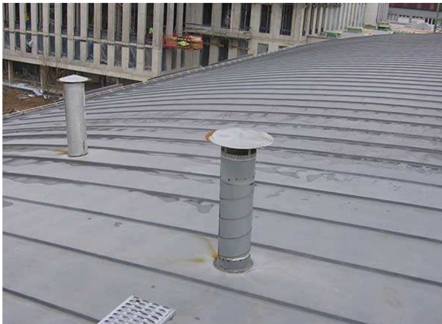
foto. widok przebicia okrągłe wentylacji przez połać, brak kołnierza usztywniającego + kołnierz wewnętrzny, nieszczelne lutowania
