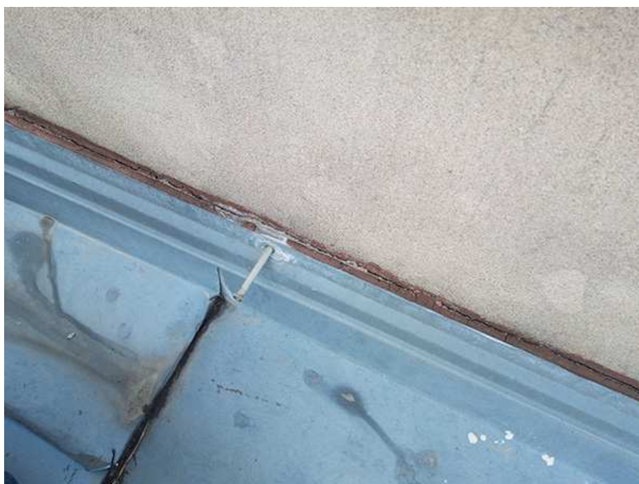
foto. widok istniejąca obróbka boczna – połączenie połaci łukowej z elewacją dachu pulpitowego. Źle zamocowana blacha, niedopuszczalne luźne wkręty zewnętrzne, spękane uszczelnienie styku żywicą.
