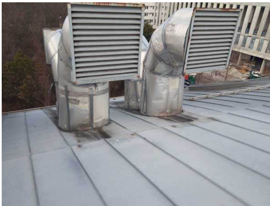
foto. istniejące czerpnie i wyrzutnie zaklejone izolacją aluminiową miękką, brak obróbki typu komin, kołnierza uszczelnienia
