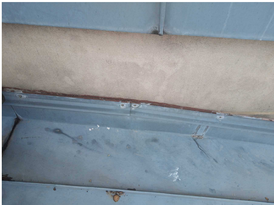
foto. widok istniejąca obróbka boczna – połączenie połaci łukowej z elewacją dachu pulpitowego. Źle zamocowana blacha, niedopuszczalne wkręty zewnętrzne, uszczelnienie styku żywicą.
