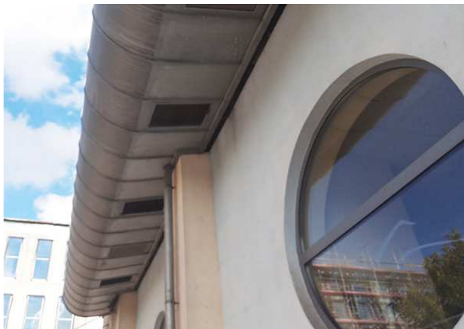
foto. widok istniejące wyoblenie okapu w miejscu z kratami wentylacyjnymi.
