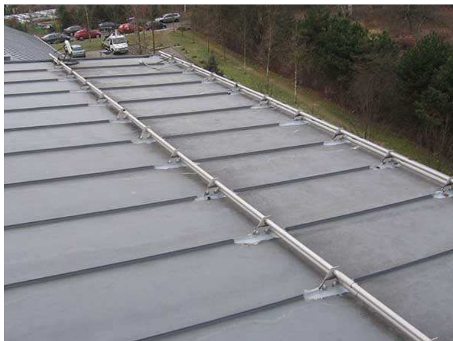
foto. widok istniejące bariery śniegowe podwójne, na dachu pulpitowym, wszystkie mocowania podklejone żywicą izolującą
