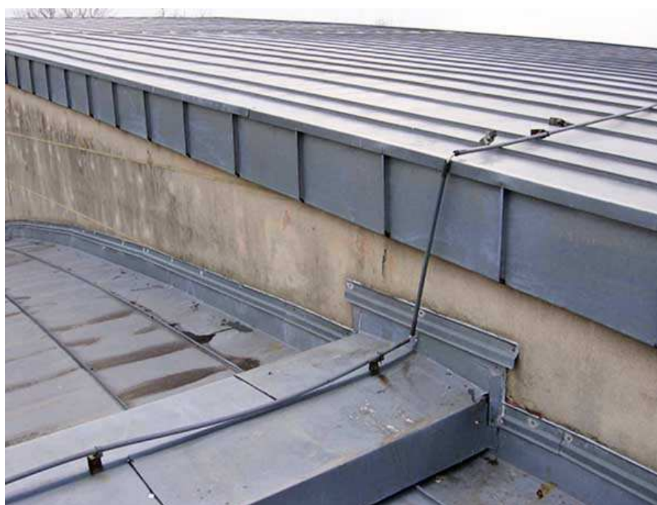
foto. widok istniejący obróbka połączenia bocznego dachu ze ścianą, uszkodzone zerwane łączniki rurki kablowej zasilającej wentylatory zlokalizowane w kalenicy dachu
