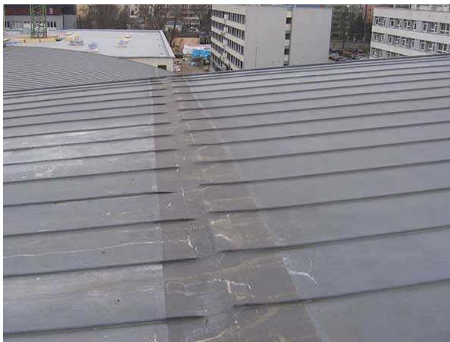
foto. widok istniejące łączenie arkuszy blachy w części pulpitowej dachu, reperowane żywicą, widoczne spękania masy reperującej
