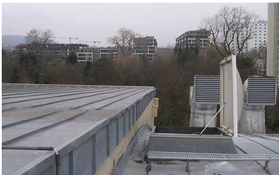
foto. widok istniejący obróbka połączenia bocznego dachu ze ścianą, miejsce łączenia arkuszy blachy, reperowane żywicą poliuretanową
