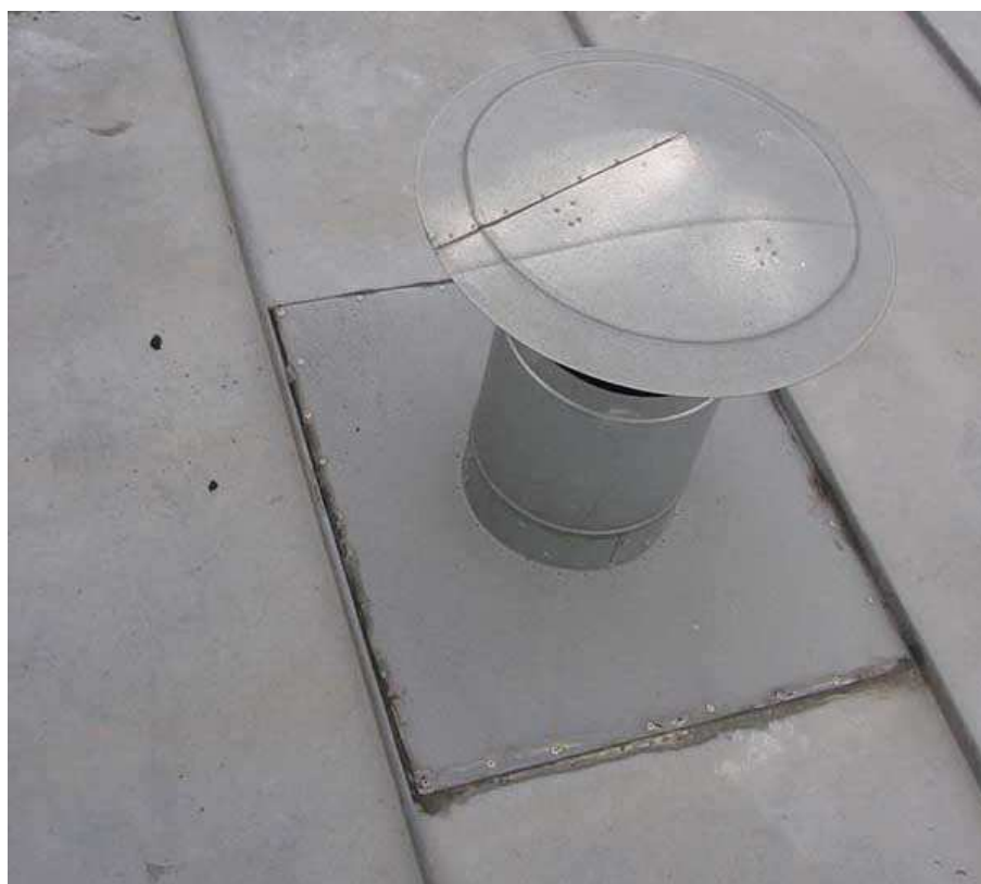
foto. widok przebicia okrągłe wentylacji przez połać, brak kołnierza usztywniającego + kołnierz wewnętrzny, zbyt niska wywiewka (zasypanie śniegiem) uszczelnienie żywicą oraz nitowanie do połaci.
