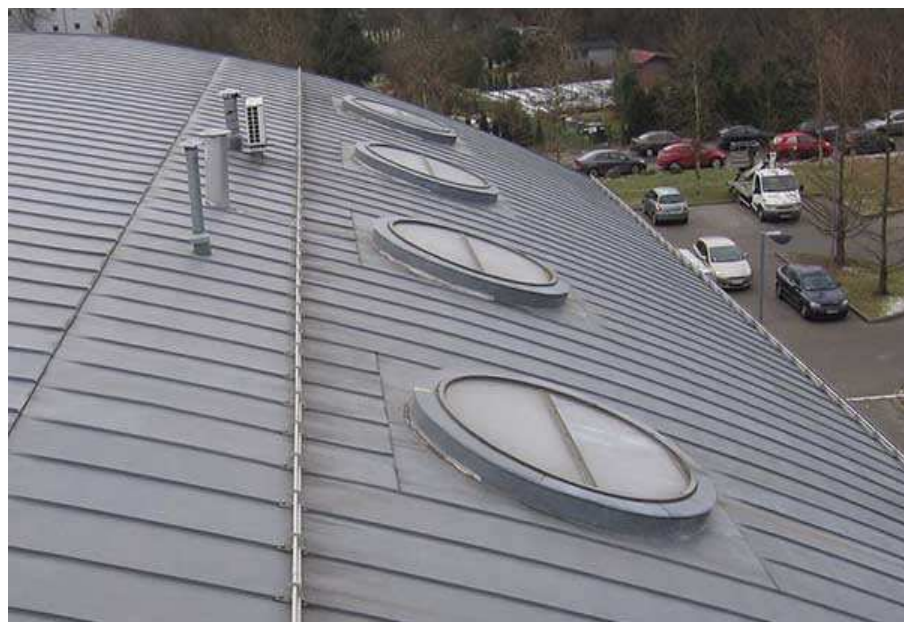
foto. widok istniejące okna w połaci łukowej dachu typu bulaj, kołnierze z blachy cynkowo-tytanowej bez tzw. przeciwsłupu
