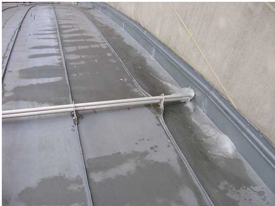
foto. widok istniejąca bariera śniegowa podwójna, uszkodzenie rąbka prawdopodobnie poprzez napór śniegu i oblodzenia
