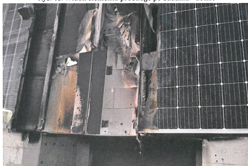
Rys. 46. Widok elementu próbnego po badaniu - detale
