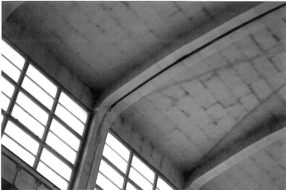
Fotografia 6 Widok na dylatację w przekryciu hali, przecięci osi C/R3.
