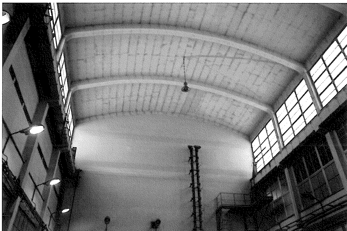
Fotografia 7 Widok na ścianę szczytową w osi R10.
