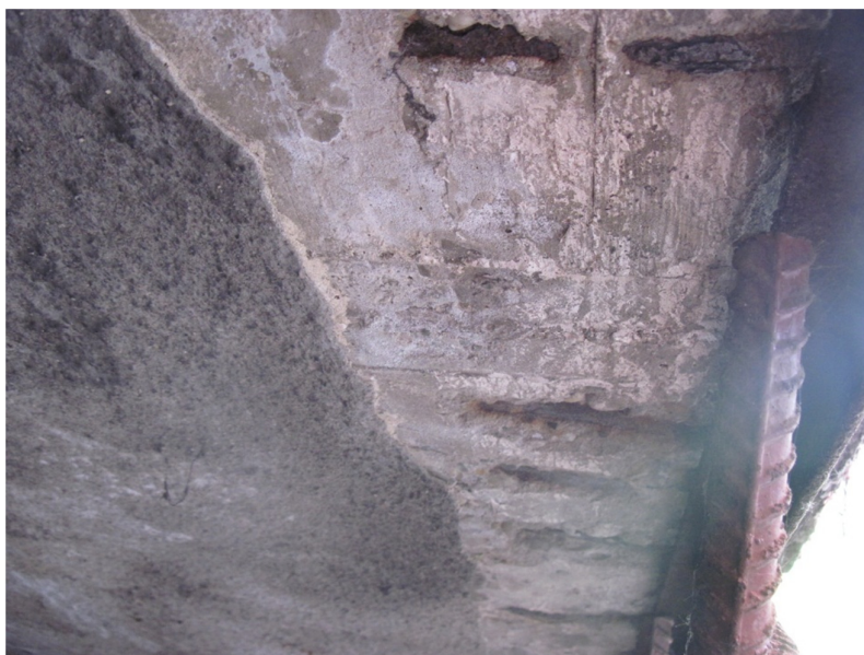
fot. 16. Skorodowane pręty zbrojeniowe na krawędzi płyty zewnętrznych frontowych schodów
