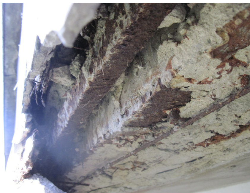
fot. 24. Skorodowane elementy stalowe zakotwione w żelbetowych belkach pod ścianami elewacyjnymi.
