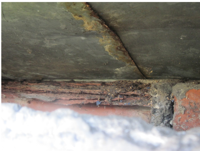
fot. 19. Zniszczone pod wpływem wilgoci cegły pod uszkodzoną obróbką blacharską – parapetem okien parteru (elewacja południowa).
