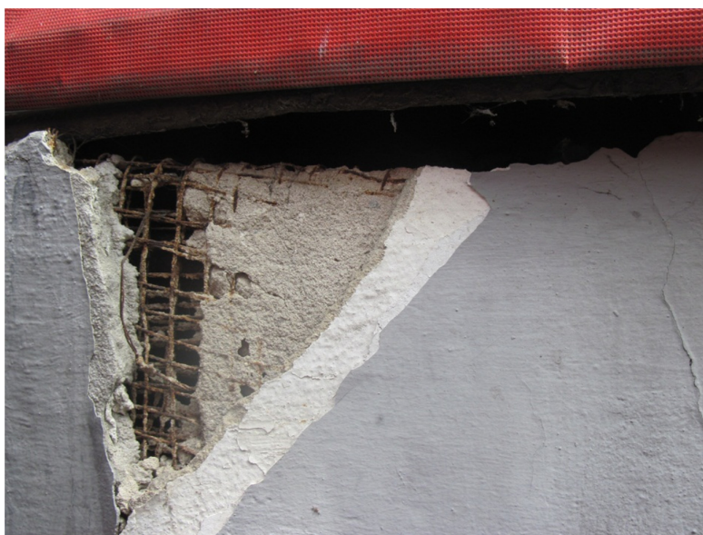
fot. 17. Korodująca siatka Rabitza doprowadziła do popękania płyt wykończenia elewacji parteru.
