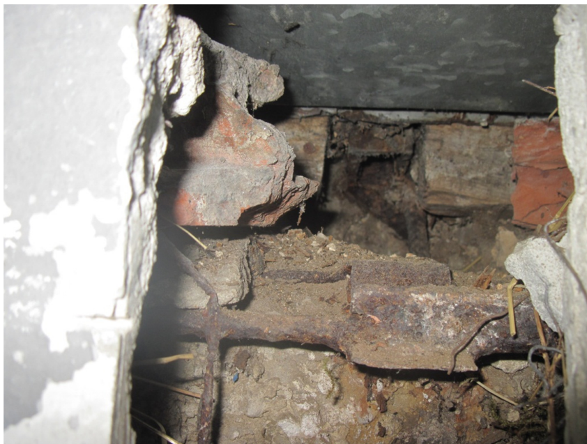
fot. 18. Korodują elementy stalowe kotwiące ślusarkę okienną z żelbetową belką nośną
