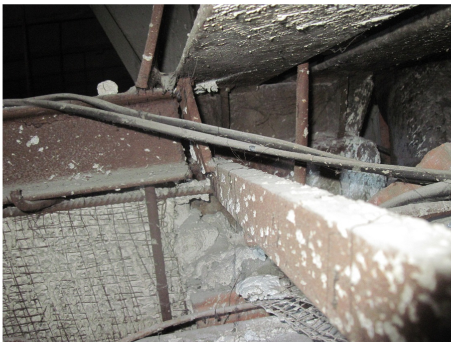
fot. 22. Powierzchniowa korozja elementów stalowych konstrukcji stropu podwieszonego i ścianek działowych.
