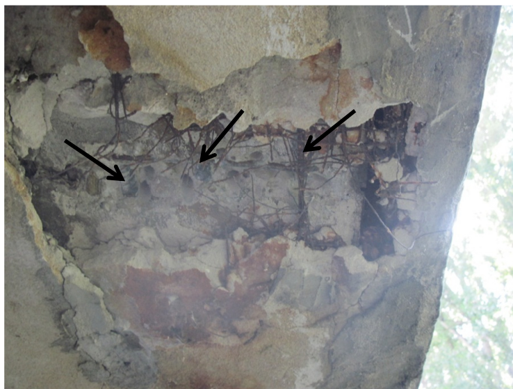
fot.5. Odkrywka zbrojenia belki pod południową elewacją
