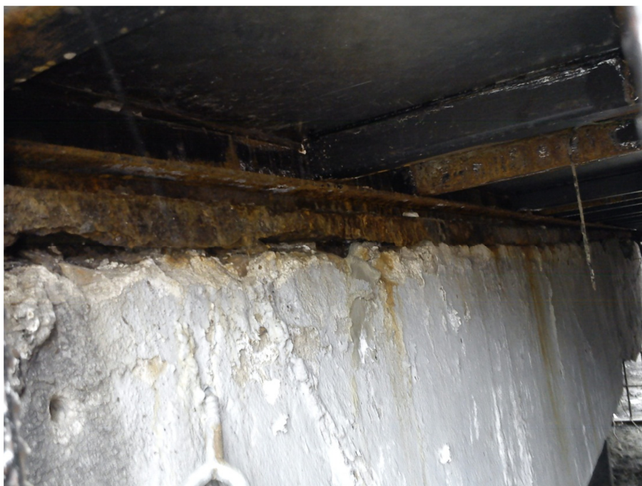
fot. 23. Skorodowane elementy stalowe pod podestem wejściowym
